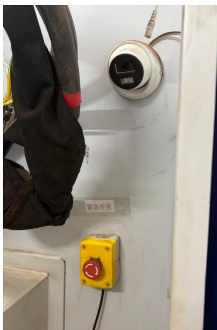
铅房内紧急停止按钮
